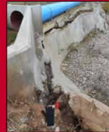
Día 28 de noviembre de 2016. Grietas en el cemento del camino de la acequia encima de la parcela.
